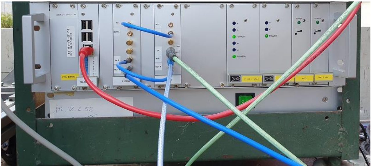
Fig. 6.1 Il cestello che contiene le conversioni di frequenza. Nella parte sottostante sono collocate le ventole di raffreddamento
