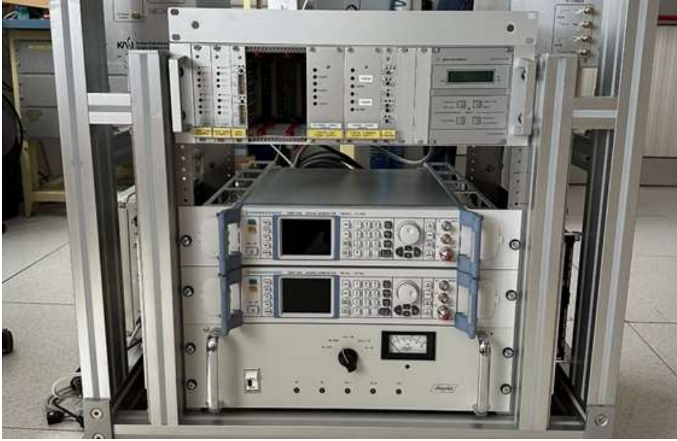
Fig. 2.5: Allestimento dei vari sistemi elettronici nella struttura di supporto.
