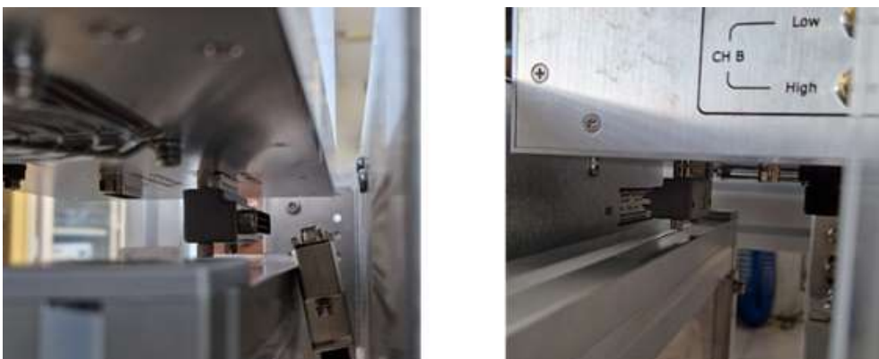
Fig. 2.6: Interferenza meccanica tra connettori e struttura.
