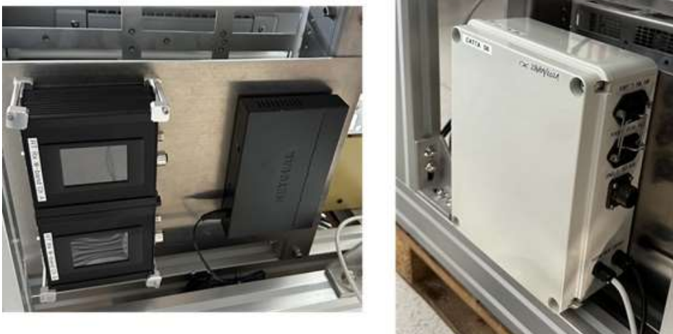
Fig. 2.8: Alimentatori per LNA in parte calda del Banda W (a sinistra) e Cryo Power Box (a destra).
