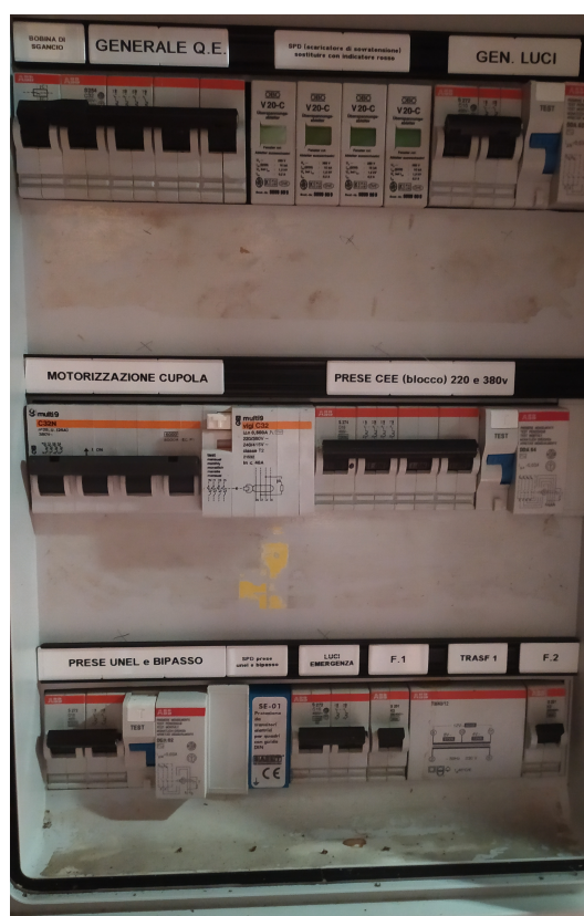
Figura 9. Quadro elettrico generale.
