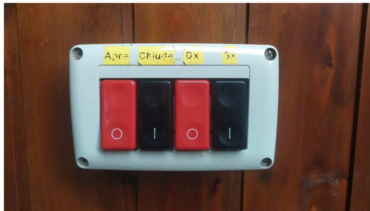
Figura 6. Sulla parete a sinistra dell'ingresso sono presenti 4 pulsanti rossi/neri per la sua movimentazione.
