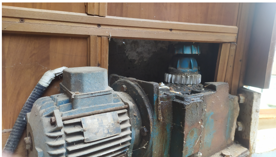
Figura A13. Motore di apertura della finestra, dove è anche visibile la manopola blu da sganciare in caso di problemi con la chiusura del portellone.
