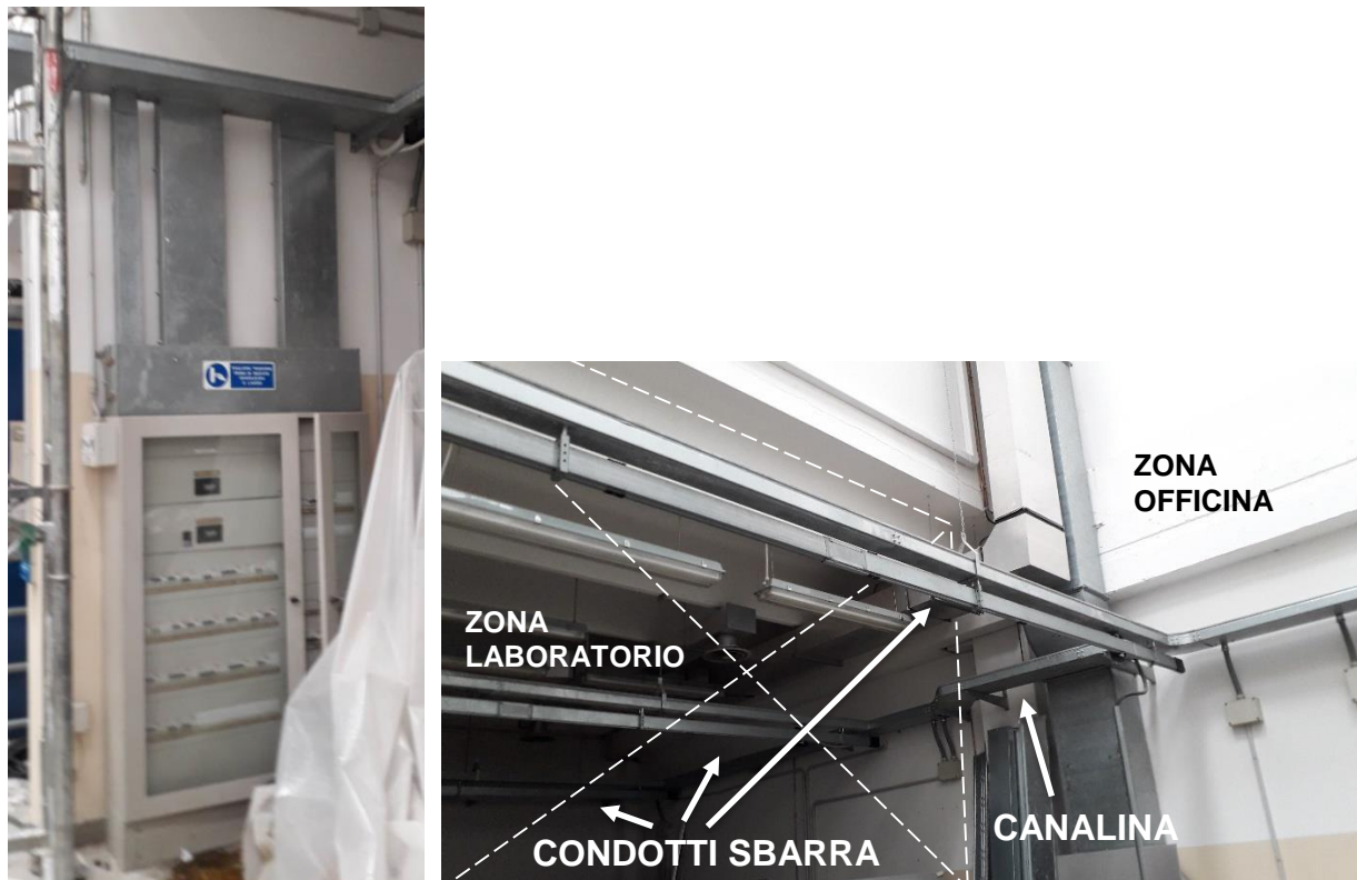
Figura 2 Sinistra: attuale quadro elettrico. Destra: canalina principale impianto elettrico e condotti sbarra; un quarto condotto sbarra, non visibile, è presente nella zona che rimarrà officina; la posizione approssimativa della nuova parete divisoria è rappresentata dal tratteggio.
