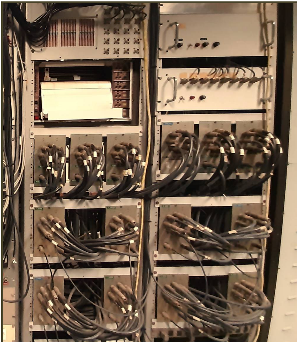
Divisori Ch per Formazione Fasci NS – Rack 27-28
