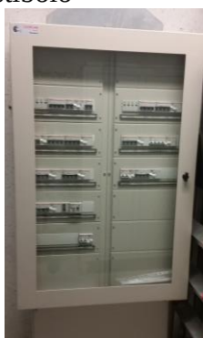
Fig. 1.c Armadio spogliatoio e appendi abiti locale 613.
